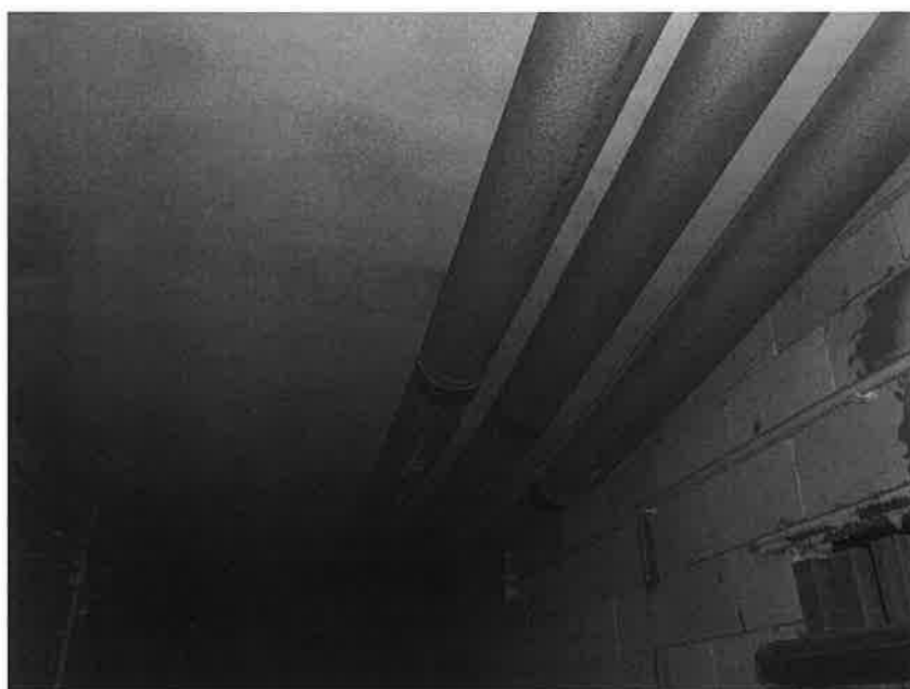
Zdjęcie nr 19- Brak elementów mocujących instalację wodną.
