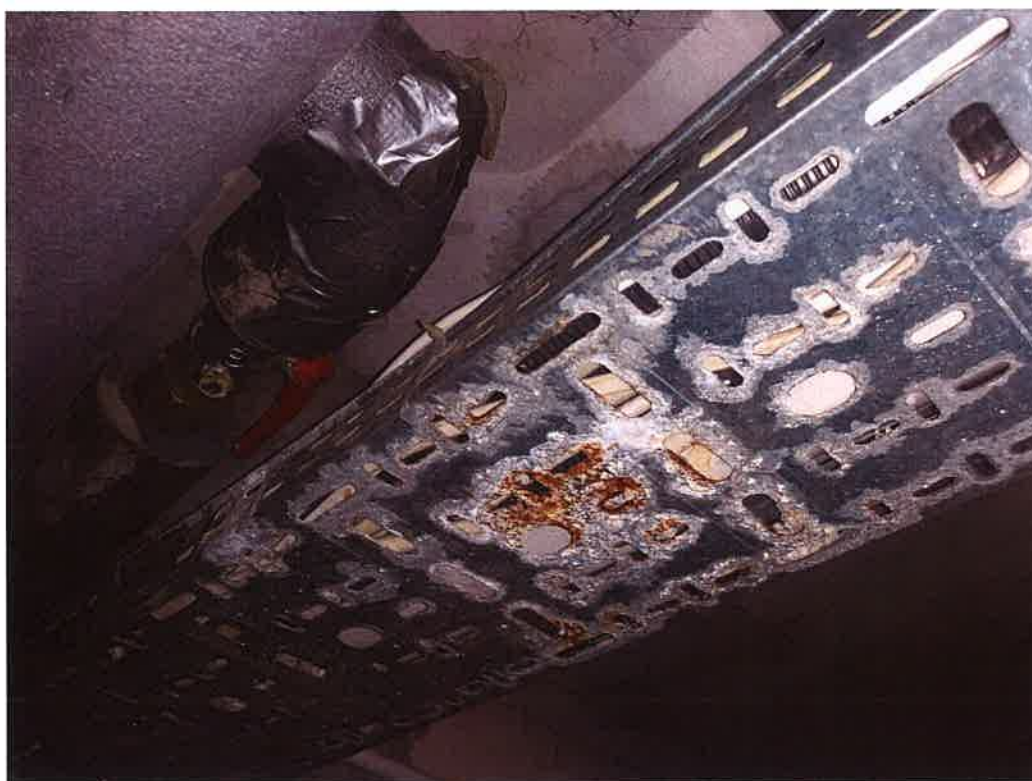
Zdjęcie nr 8- Skorodowane elementy mocujące instalację.
