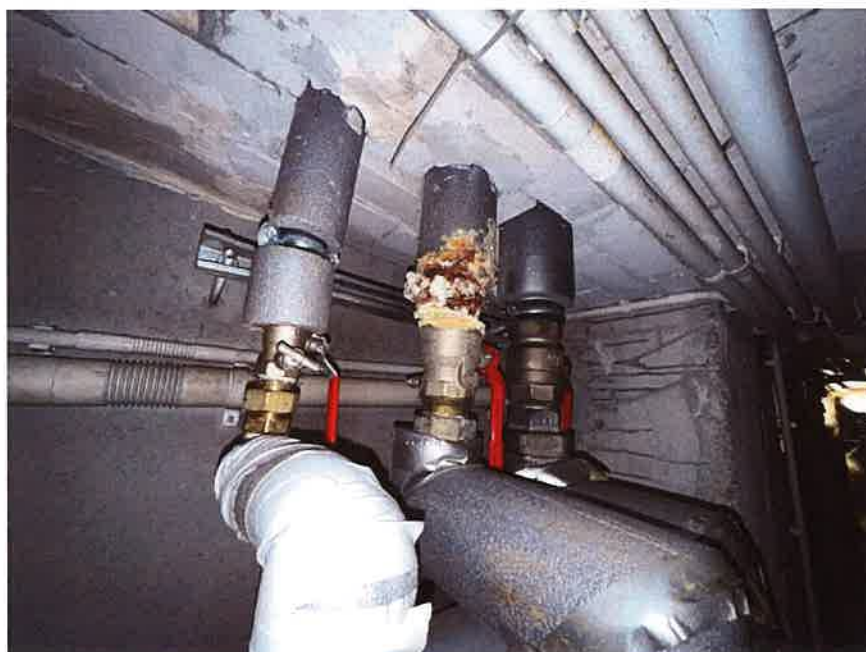
Zdjęcie nr 2- Skorodowane przewody oraz kształtki istniejącej instalacji wodnej.
