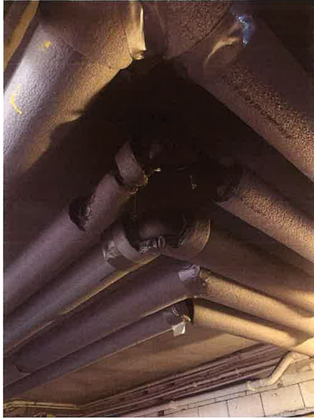
Zdjęcie nr 10- Ubytki w izolacji termicznej.
