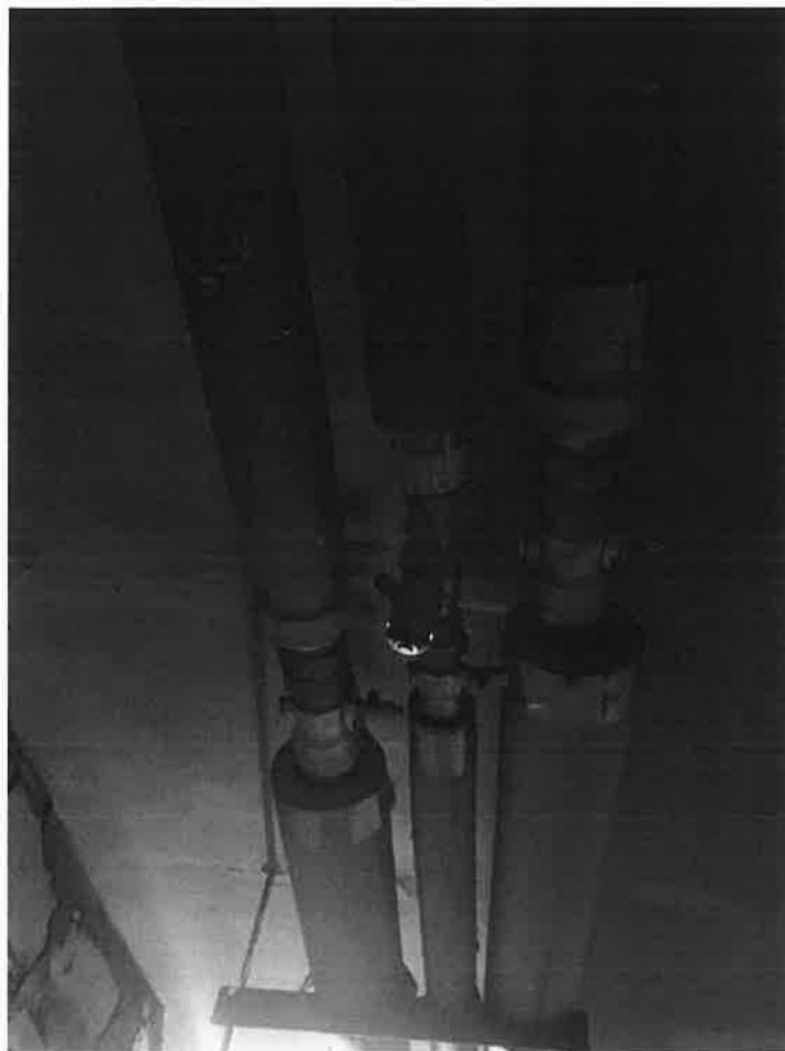
Zdjęcie nr 18- Brak rączek przy zaworach odcinających.
