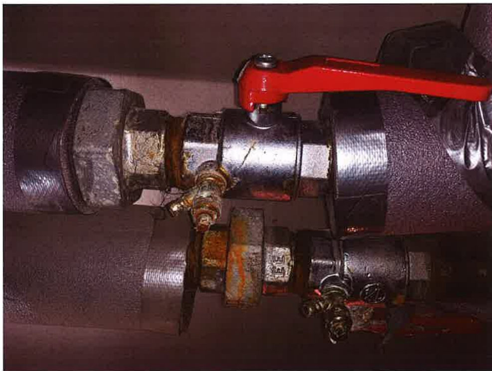
Zdjęcie nr 6- Skorodowane przewody oraz kształtki istniejącej instalacji wodnej.
