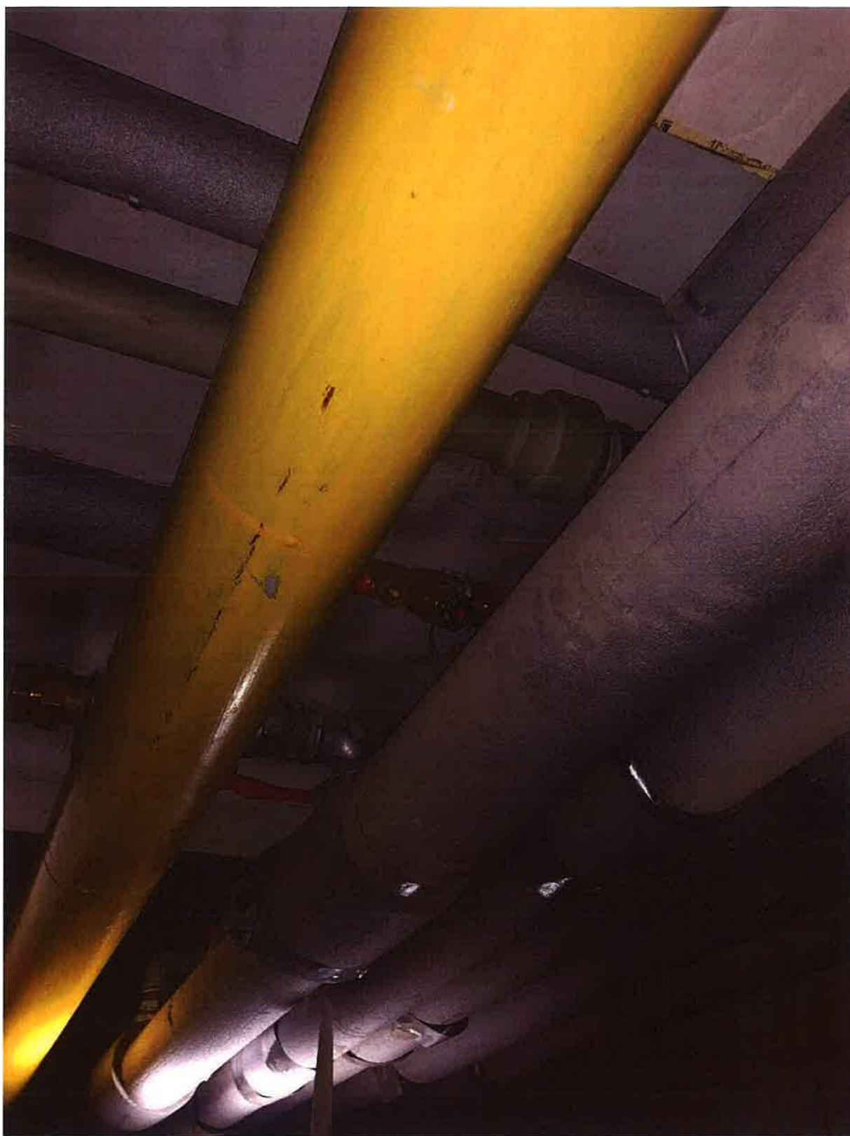
Zdjęcie nr 12- Zawory podpionowe umieszczone pod stropem nad rurą gazową oraz nad rurami wodnymi, brak funkcjonalności – konieczność zamontowania ich w częściach wspólnych piwnicy.
