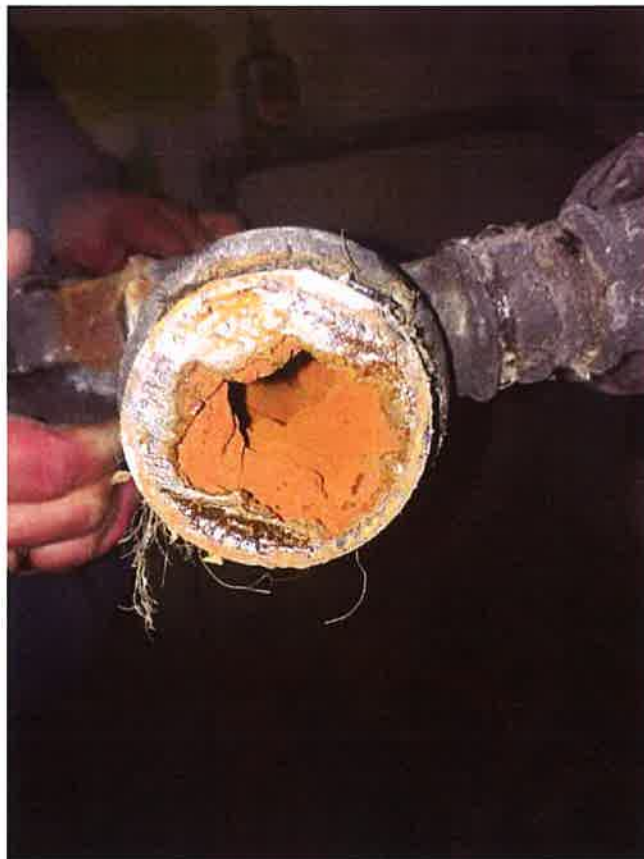
Zdjęcie nr 21- Przykład skali zakamienienia wewnątrz instalacji wodnej w budynku o zbliżonych parametrach
