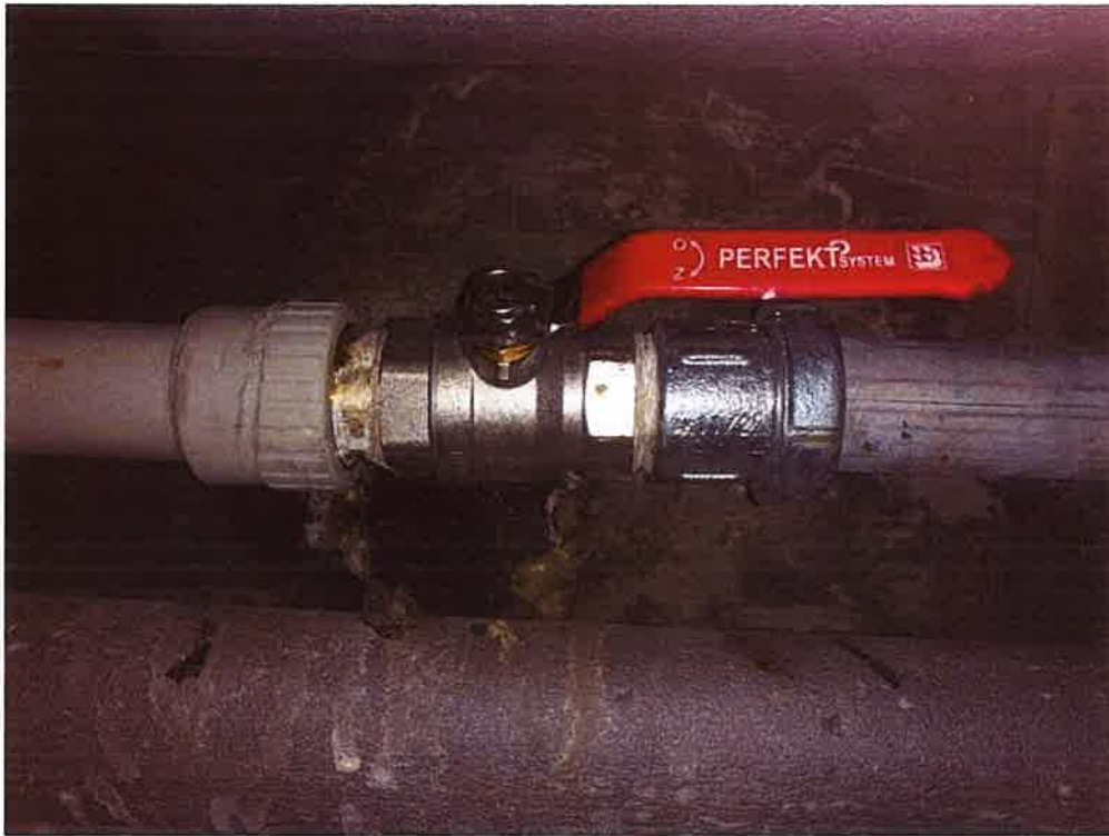
Zdjęcie nr 20. Fragmenty instalacji wymienione na przewody z PP ze względu na awarię. Naprawa tymczasowa instalacji za pomocą kształtki serwisowej GEBO.
