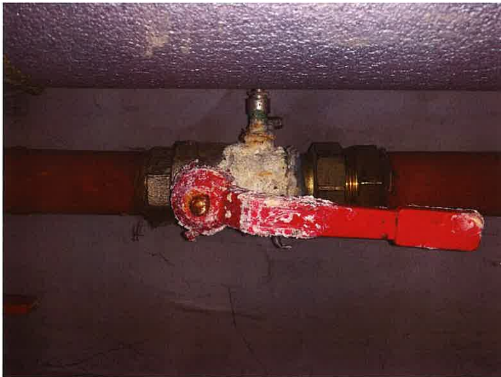
Zdjęcie nr 4- Skorodowane przewody oraz kształtki istniejącej instalacji wodnej.
