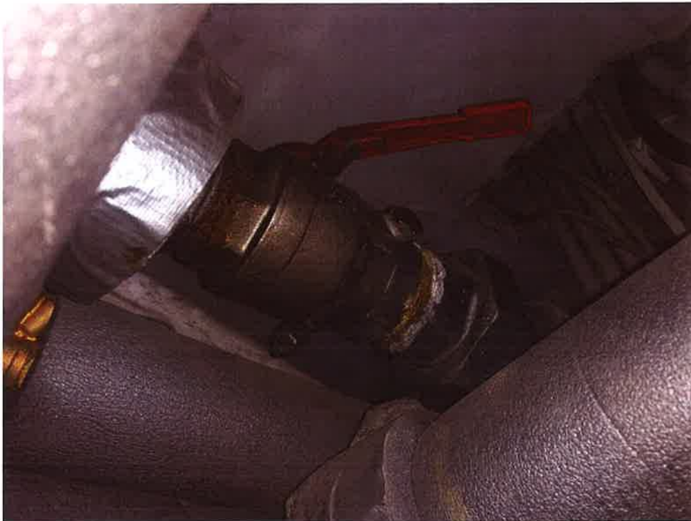
Zdjęcie nr 5- Skorodowane przewody oraz kształtki istniejącej instalacji wodnej.
