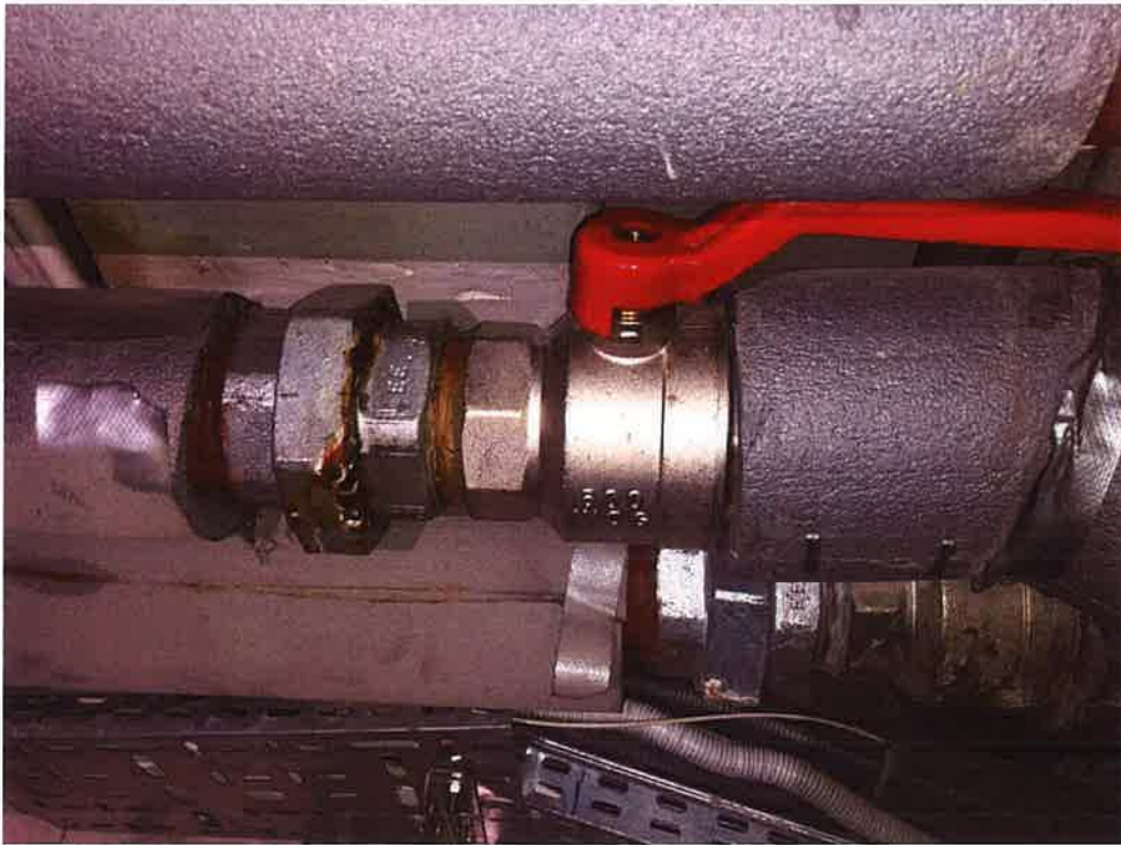
Zdjęcie nr 3- Skorodowane przewody oraz kształtki istniejącej instalacji wodnej.
