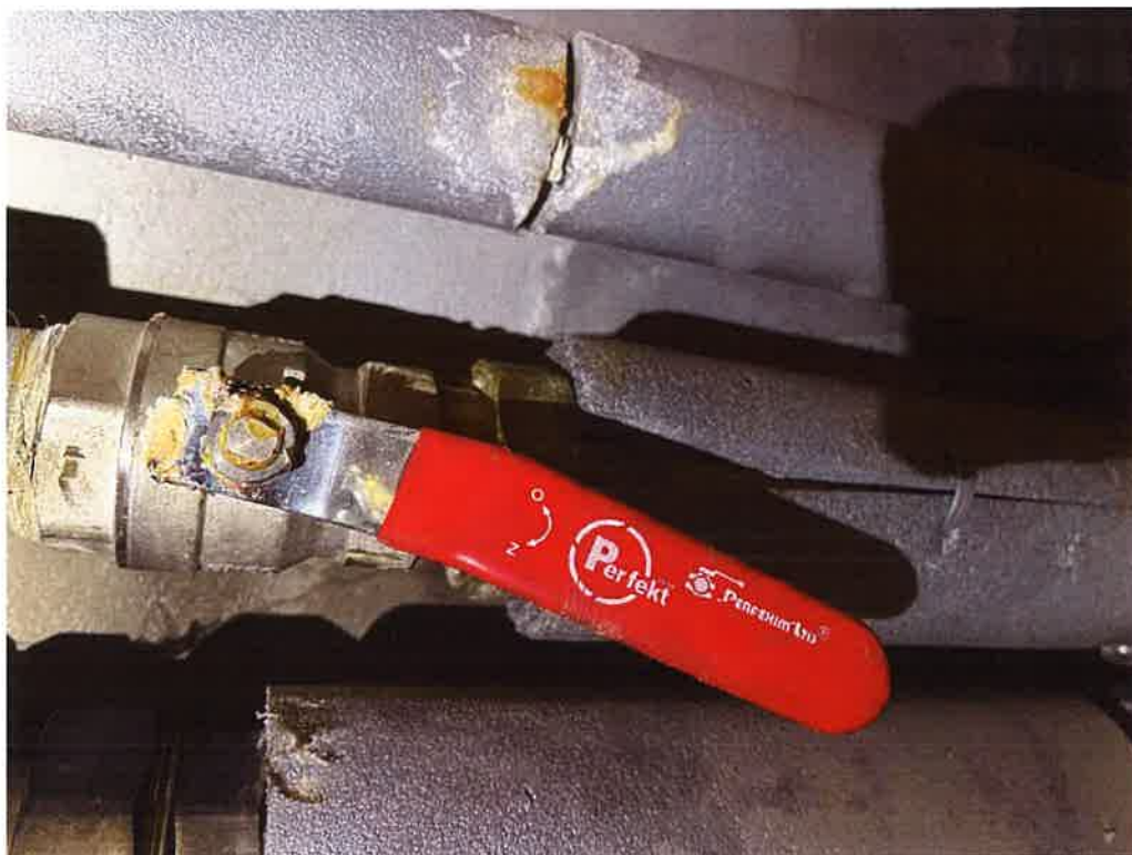
Zdjęcie nr 7- Skorodowane przewody oraz kształtki istniejącej instalacji wodnej.
