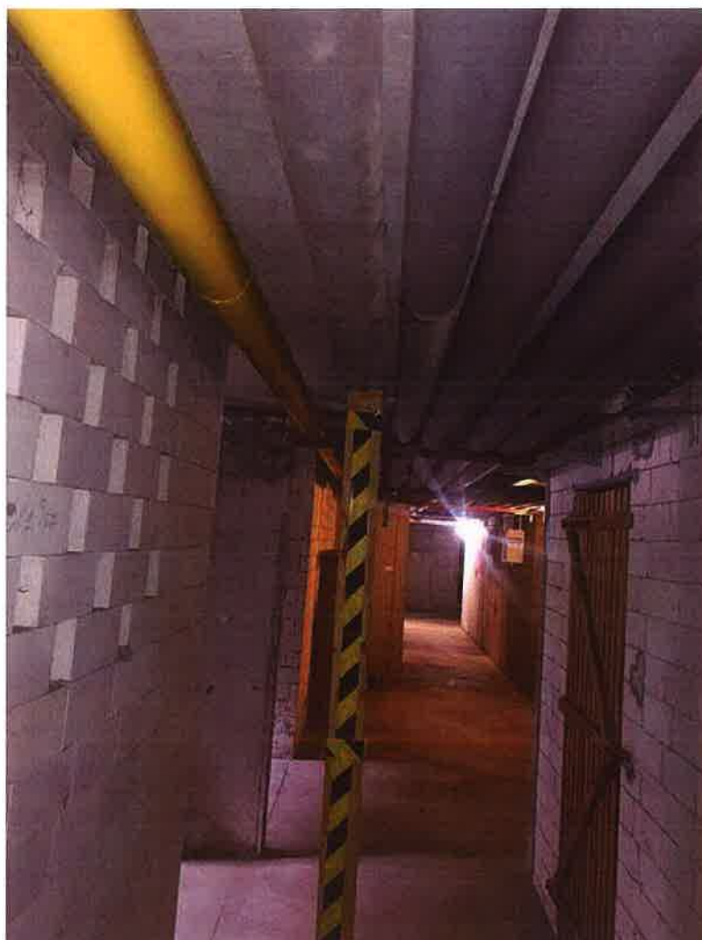
Zdjęcie nr 9- Brak elementów mocujących instalację wodną- prowizoryczna podpórka.
