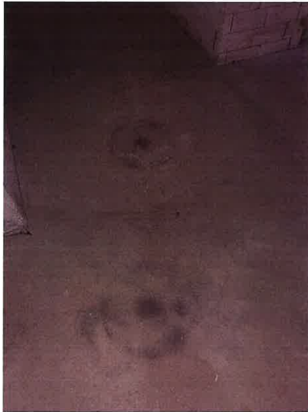
Zdjęcie nr 14- Pozostałości po zalaniach na posadzce podłogi.
