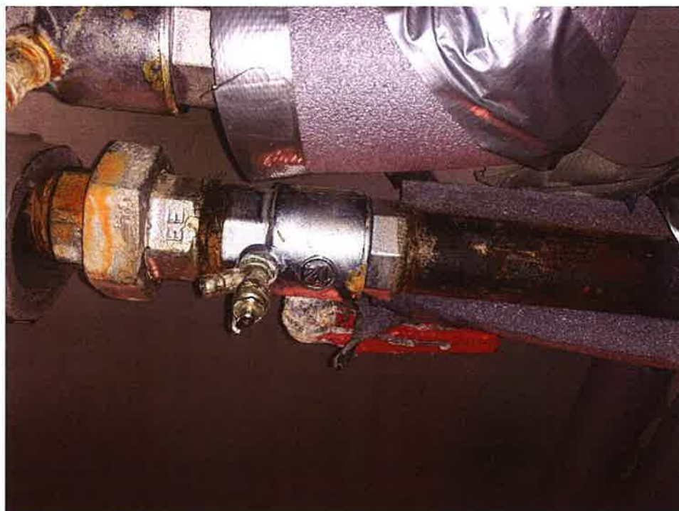
Zdjęcie nr 17- Skorodowane przewody oraz kształtki istniejącej instalacji wodnej.
