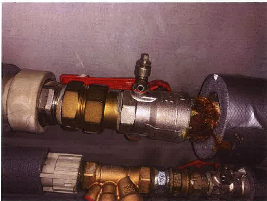
Zdjęcie nr 16- Skorodowane przewody oraz kształtki istniejącej instalacji wodnej.
