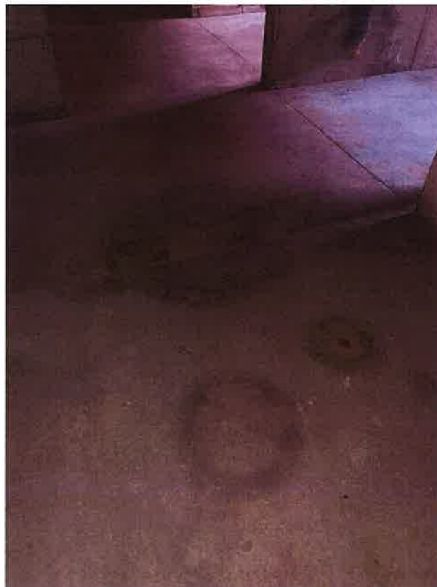
Zdjęcie nr 15- Pozostałości po zalaniach na posadzce podłogi.
