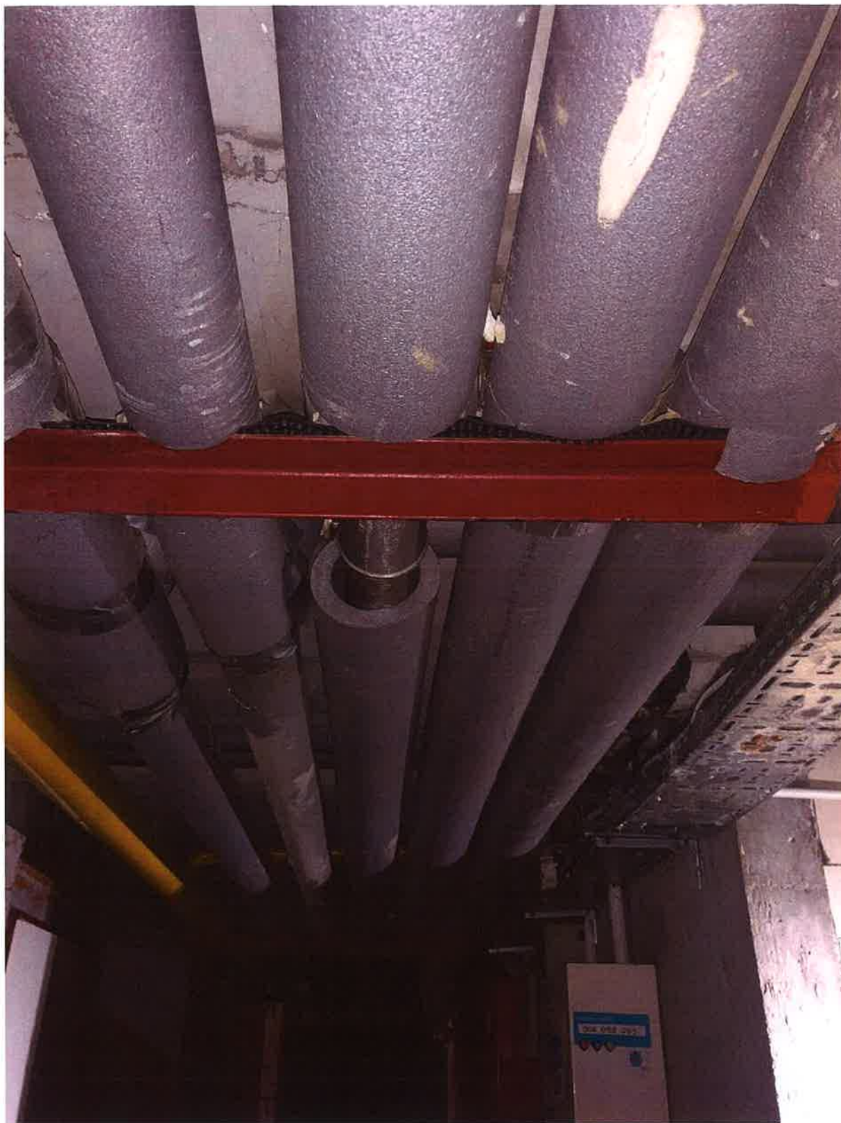
Zdjęcie nr 13- Zawory podpionowe umieszczone pod stropem nad rurami, brak funkcjonalności – konieczność zamontowania ich w częściach wspólnych piwnicy.
